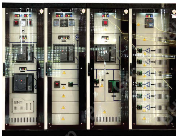
TỦ ĐIỆN ATS ATS Panel
