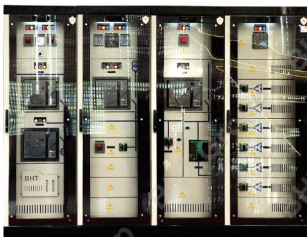
TỦ ĐIỆN ATS ATS Panel
