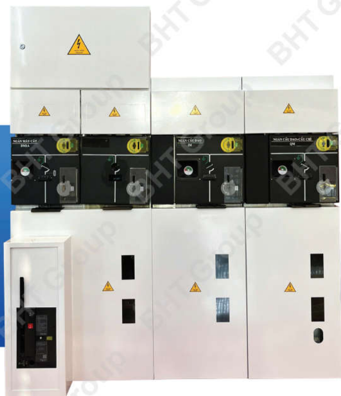
TỦ ĐIỆN TRUNG THỂ Medium Voltage Switchboard
