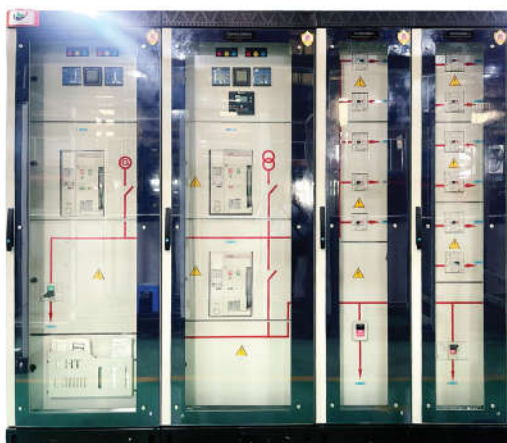
TỦ ĐIỆN PHÂN PHỐI TỔNG Main Distribution Board (MDB)
